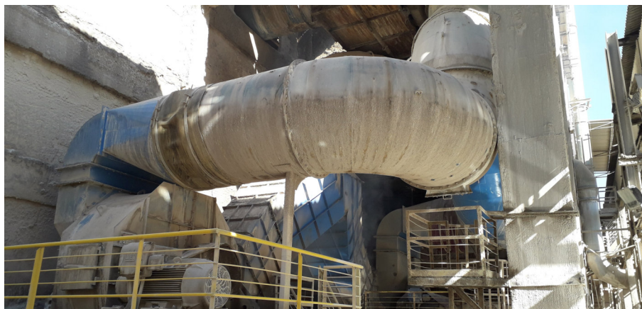
Figura 1: Imagem externa real da tubulação industrial. Fonte: Elaborada pela autora (2019)
