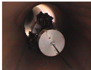
Figura 2.19: Sistema robótico de inspeção de gasoduto.
