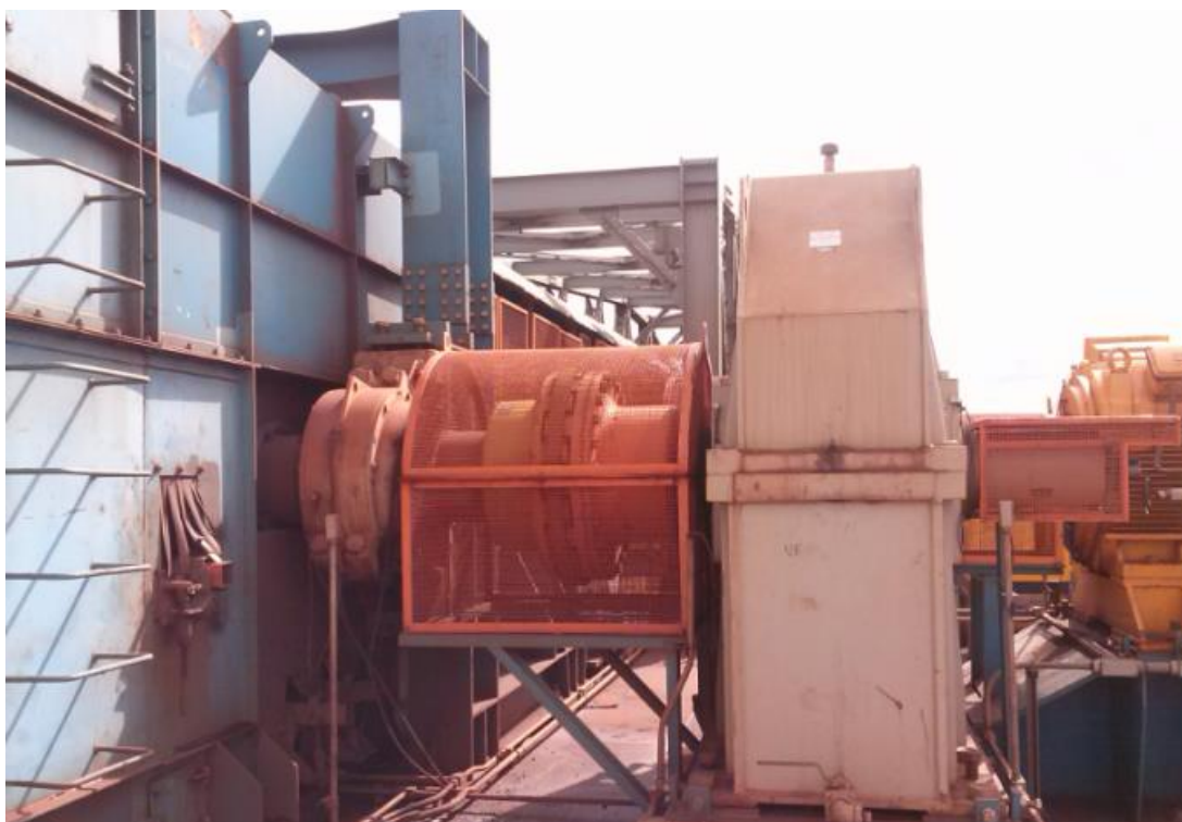
Figura 13 – Acionamento de correia transportadora.
