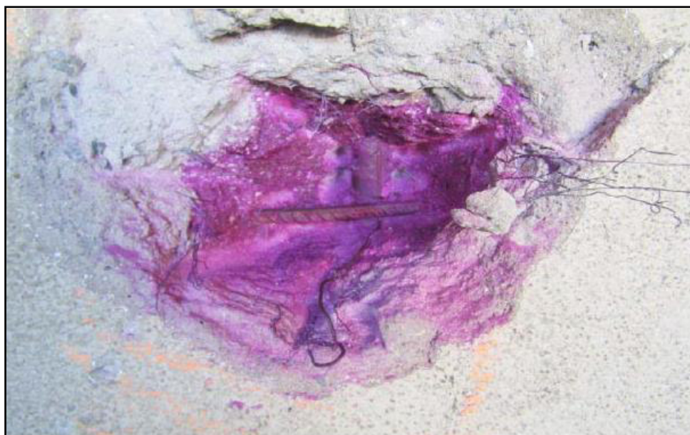
Figura 9 - Ensaio de carbonatação em viga
