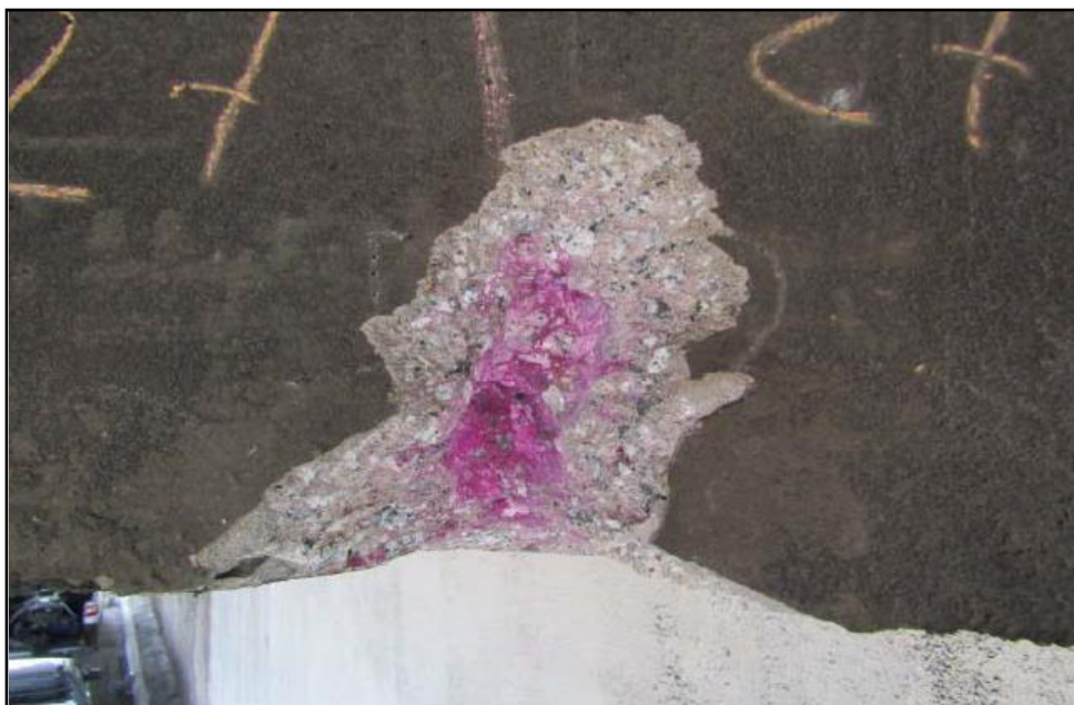
Figura 10 - Ensaio de carbonatação em viga
