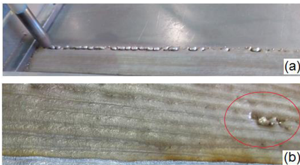
Figura 41 – Problemas na execução do revestimento
