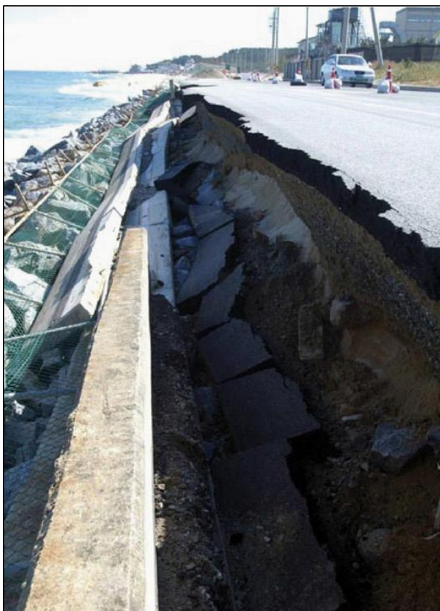
Figura 3 – Erosão costeira impactando infraestrutura rodoviária of east coast of Korea (Young-Jin beach). Fonte: Adaptado de Souza et al. (2005).
