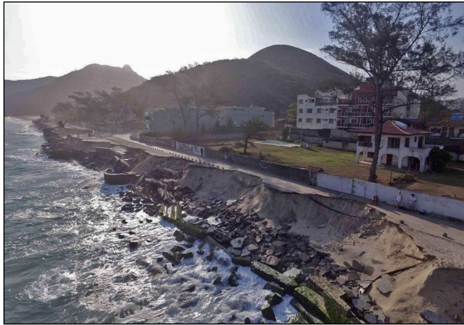
Figura 4 - Erosão Costeira e destruição de infraestrutura pública e privada em área urbana após tempestade, Praia da Macumba, Rio de Janeiro, RJ. Em 15 anos tal estrutura colapsou ao menos cinco vezes. Fonte: Thiago Pereira, 2017 retirado de Muehe, D.(2020).
