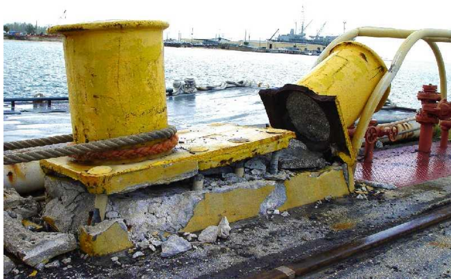
Figura 1.1 - Desprendimento dos Cabeços de Amarração (Fonte: BLT Bollard Load Test, visto em: http://bollardloadtest.com/examples-and-consequences-of-failed-bollards/ ).
