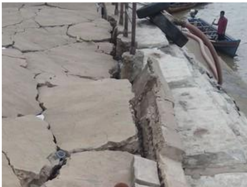
Figura 1.1.1- Danificação na estrutura devido a atracação indevida (Fonte:
